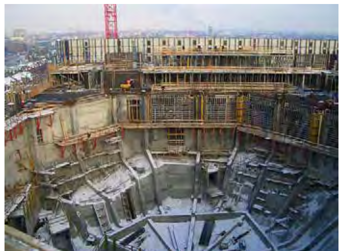
Bild 15. Massive Außenschale Saaltopf (© 2014, HOCHTIEF) Fig. 15. Concrete exterior shell bowl of the great concert hall
