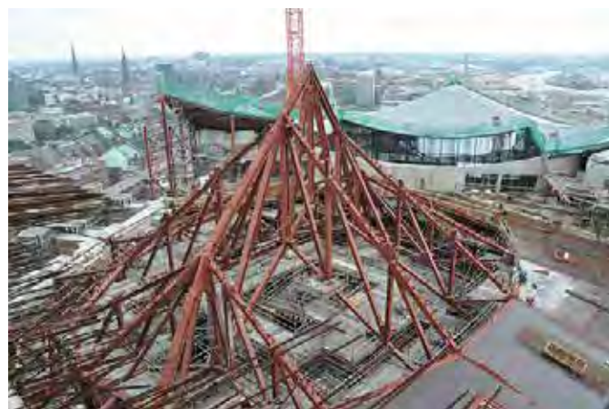
Bild 13. Stahlkonstruktion der Saaldach-Außenschale (© 2014, HOCHTIEF) Fig. 13. Steel structure of the concert hall roof exterior shell
